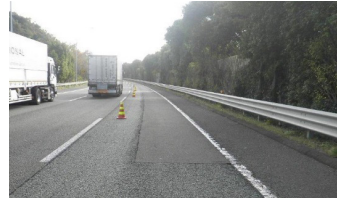
舗装損傷状況
